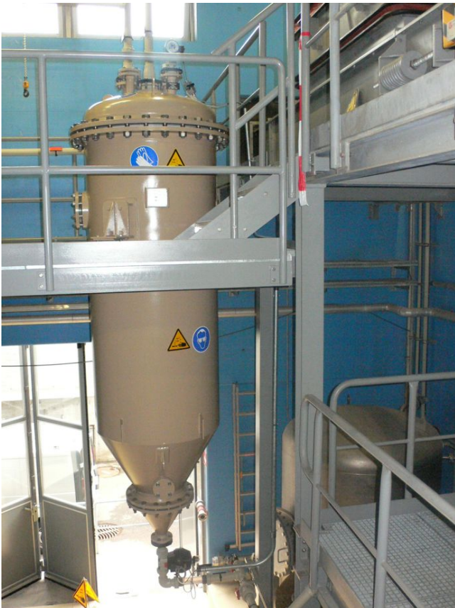
Abbildung 4: Kerzenfilter für die Vorfiltration in der KVA Limmattal (CH)
