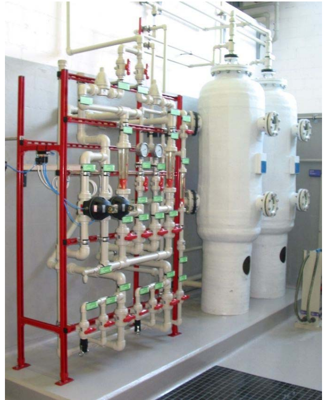
Abbildung 5: Ionenaustauscherkolonnen für die Quecksilberabscheidung in der KVA Niederurnen (CH)
